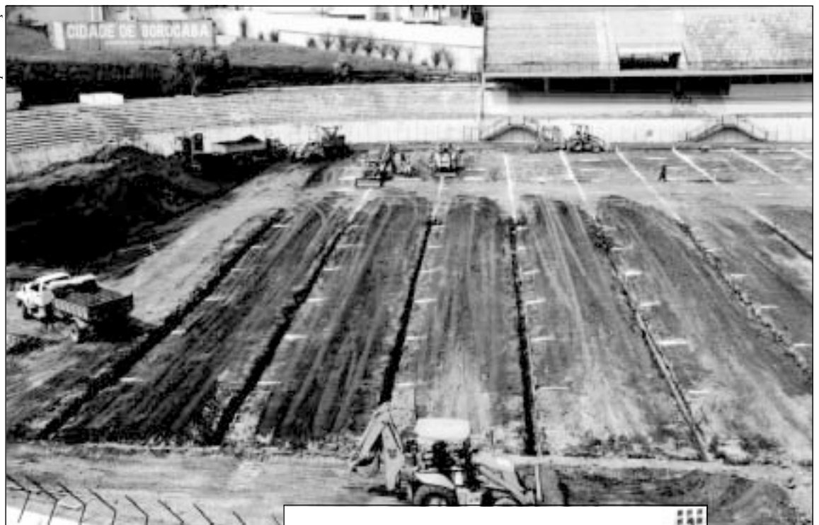
▲ Sistema de drenagem será formado por 19 valetas e tubos que levarão a água do centro do campo para as extremidades
