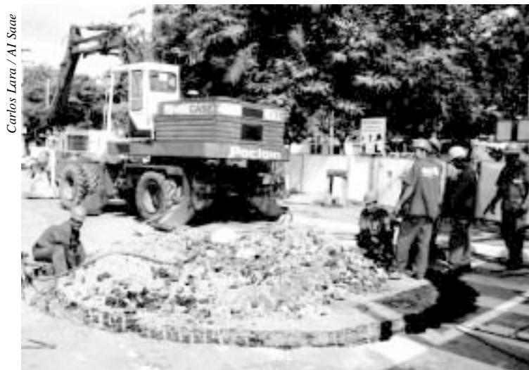
A atual etapa da implantação do coletor tronco percorre um trecho de 120m, que se inicia na praça da Bandeira e segue pela Afonso Vergueiro
