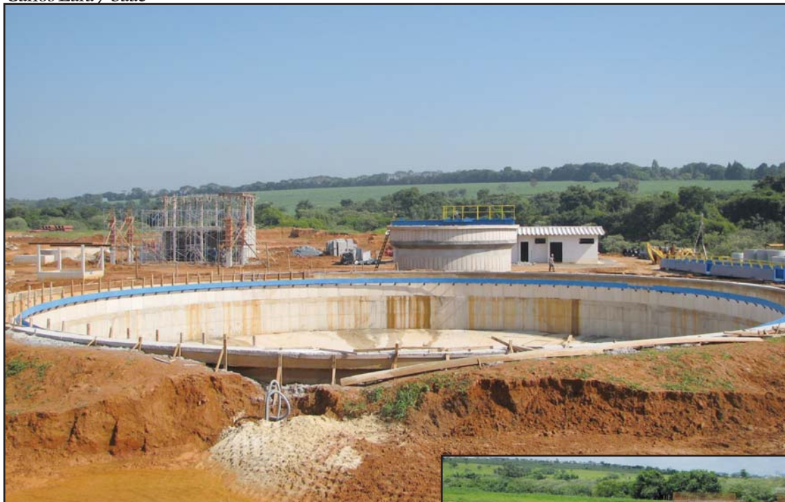
A ETE S-2 será responsável pelo tratamento do esgoto de parte da Zona Norte e dos bairros Cajuru e Éden.
