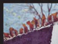
Cacos de Vidro nos Muros
