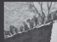
Cacos de Vidro nos Muros
