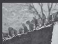
Cacos de Vidro nos Muros
