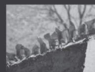
Cacos de Vidro nos Muros
