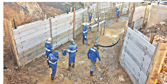
Muros têm objetivo de proteger as duas encostas laterais e as pilstras de sustentação das adutoras
