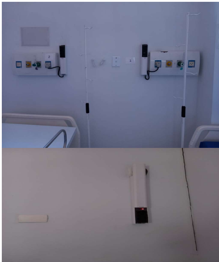
Colocação de 40 régua de alimentação elétrica para os leitos de Enfermaria piso superior
