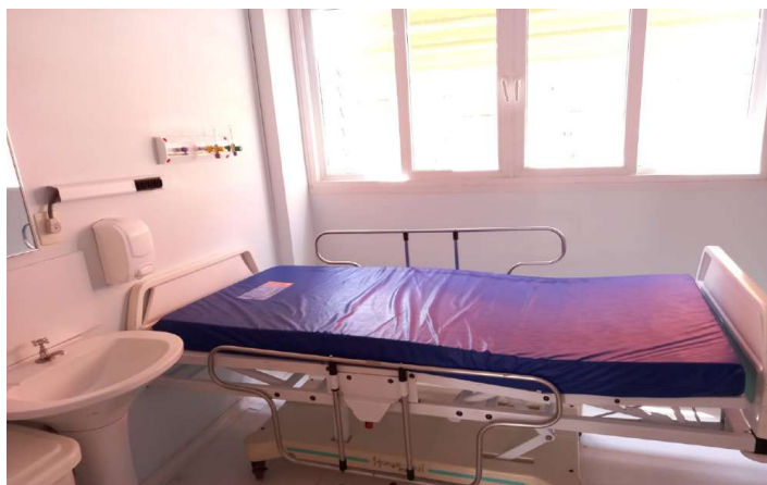
Régua de alimentação elétrica e de gás medicinal (oxigênio e ar comprimido), colocação de fluxômetros para rede de gás medicinal.
