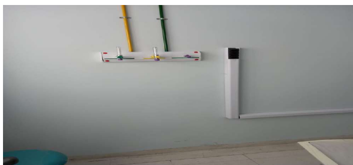
Régua de alimentação elétrica e de gás medicinal (oxigênio e ar comprimido)
