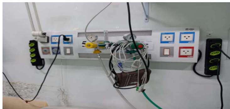
Régua de alimentação elétrica 2 por leito na estabilização 46 no total
